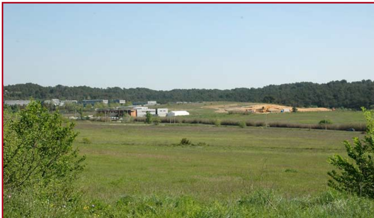
Début du terrassement en juin 2007. Au premier plan, le Centre de Biologie et de Gestion des Populations, à l'arrière-plan le CIRAD.
