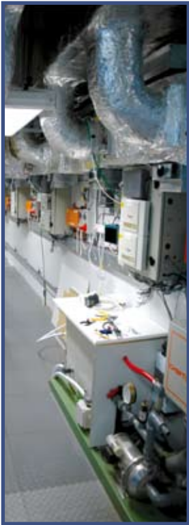
Système de régulation de l'air injecté dans des enceintes
